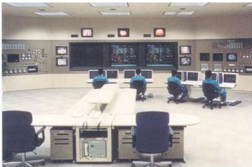
Hình H-31 Hình ảnh phòng điều khiển trung tâm nhà máy lọc dầu.
