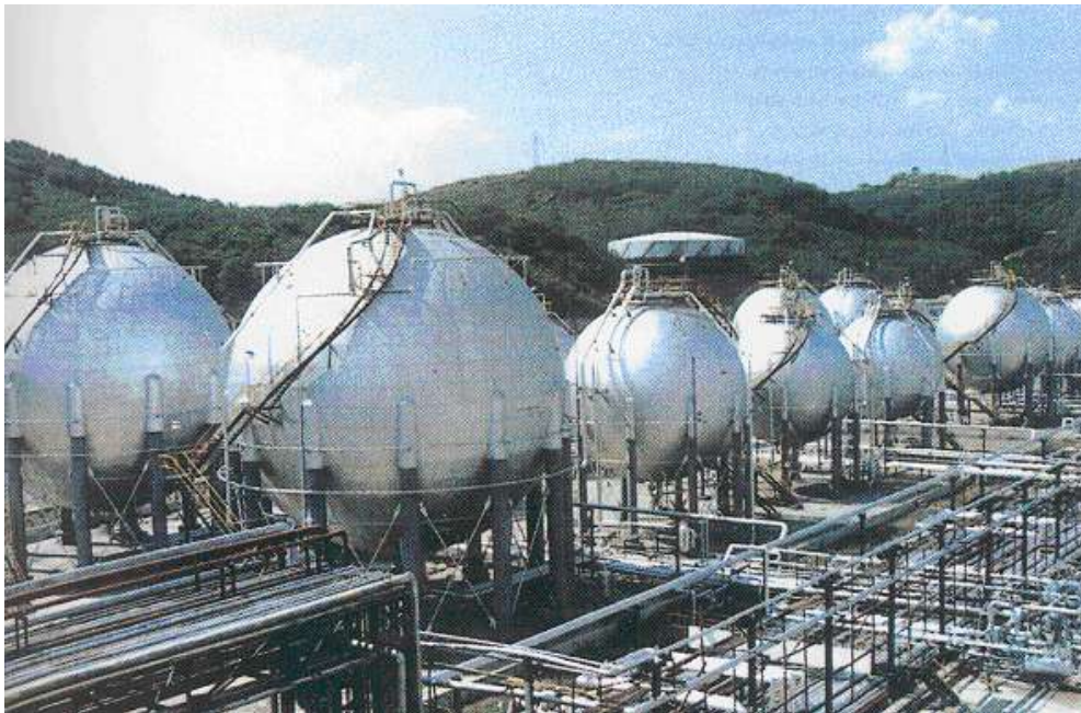
Hình H 23 A- Bể chứa khí hóa lỏng hình cầu
