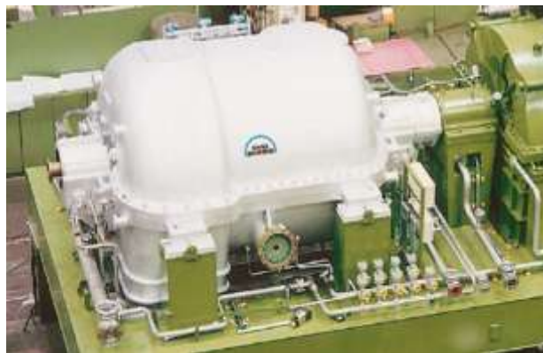
Hình H-3.10- Hình ảnh máy nén hướng trục lắp đặt trong phân xưởng cracking xúc tác tầng sôi
