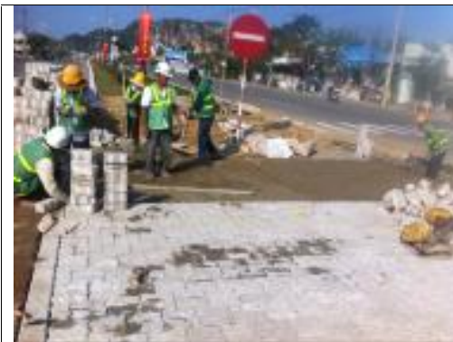
Công tác thi công lát 210m 2 g ch t chèn b ng th công
