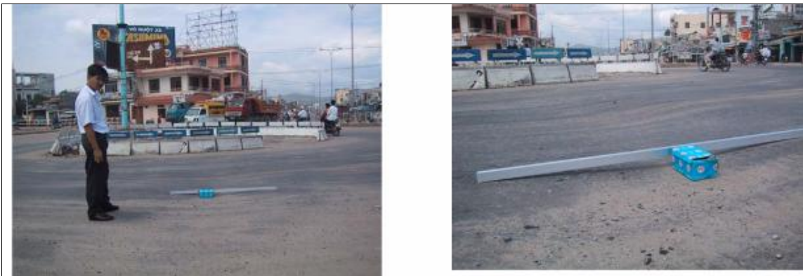
Hình ảnh mô tả hình thức BTN trong vòng xuy n Ngã Ba Hu - à N ng, sau khi th m bê tông nh a c 3 tháng. nh ch p tháng 8 n m 2002.
