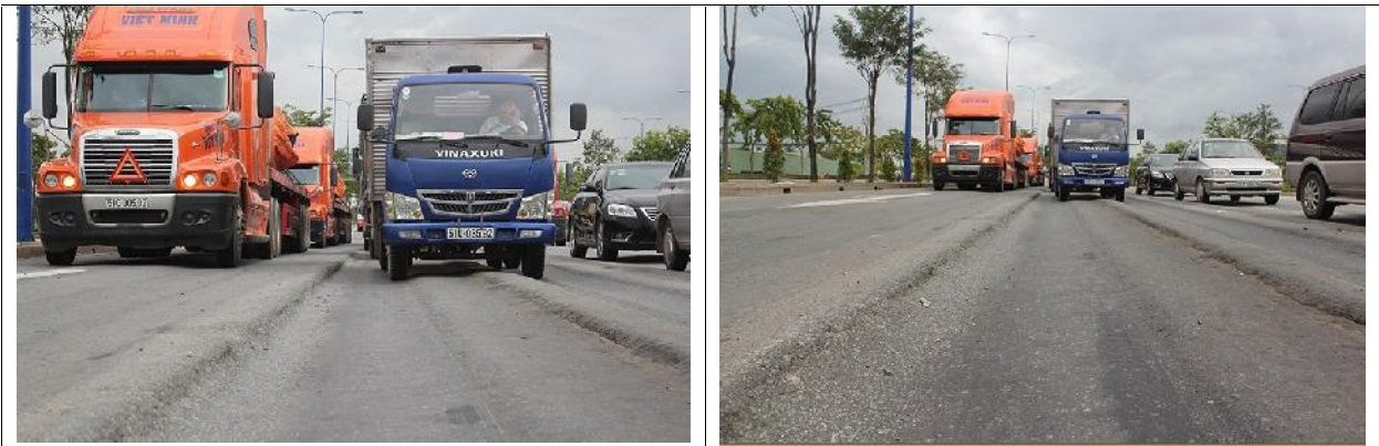
Lún và vết nứt trên mặt đường bê tông nhựa nóng nhờ chi phí thấp tháng 11 năm 2013 trên đường làm đường tránh ở Cầu Cát Lái
