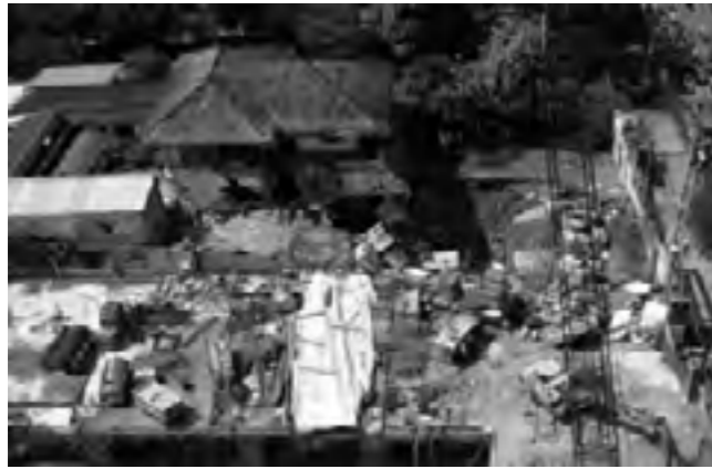
Hình 2. Viện Phát triển bền vững vùng Nam bộ bị hư hại nặng do sự cố công trình bên cạnh
