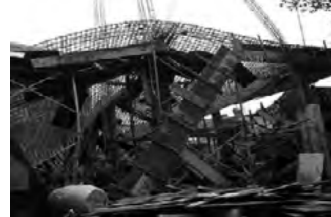
Hình 4. Sự cố sập sàn sau khi đổ bê tông
