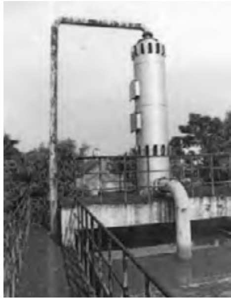
Hình 1.1. Công trình cấp nước trị giá nhiều tỷ đồng đang bị bỏ hoang
