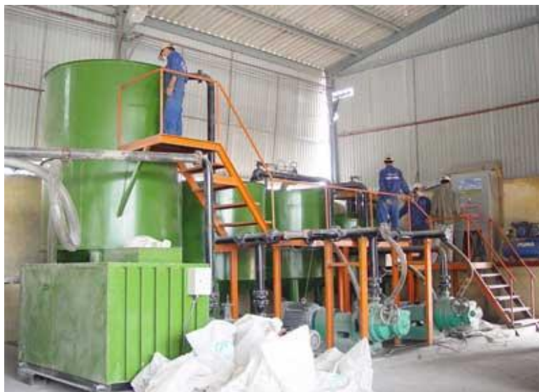
Hình 13: cụm thiết bị chuẩn bị nguyên liệu được lắp đặt tại Công ty Thuận Cường
