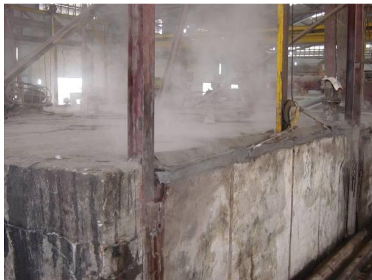
Hình 9: Rò rỉ hơi tại hầm ủ hơi nước
