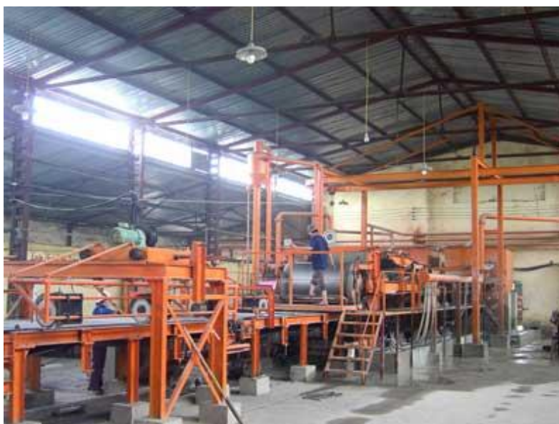
Hình 14: thiết bị xeo tại Công ty Thuận Cường
