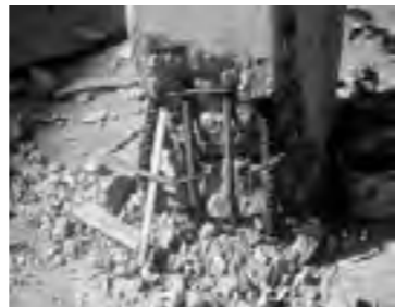
Hình 10. Các cột đai chân cột khung cũng bị hư hỏng do uốn góc 90° (Turkey, Izmit 1999)
