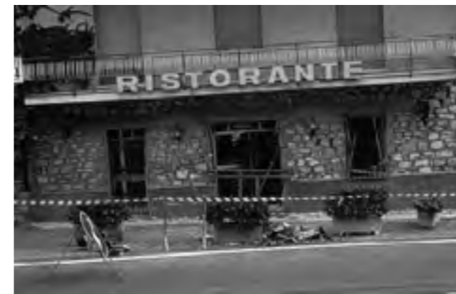
Hình 4. Các cột gạch ở tầng trệt của nhà hàng ứng xử như cột ngắn. Chúng bị hư hỏng nặng do các vết nứt chéo (Umbria, Italy 1997)
