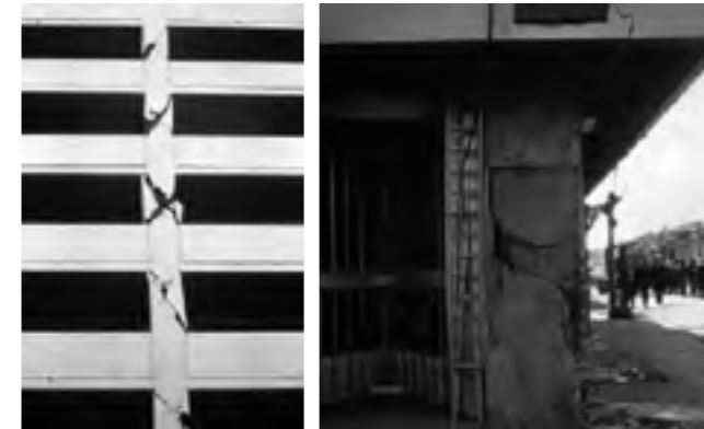
Hình 2,3. Các vết nứt chéo và phá hoại cắt trong các cột ngắn của một gara ô tô cao tầng gần như gây ra sụp đổ (Northridge, California 1994)
