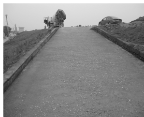
Hình 2: Hiện trạng bong tróc ở dốc bê tông
