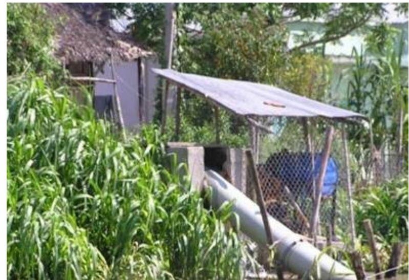
Hình 10: Hệ thống bơm nước
