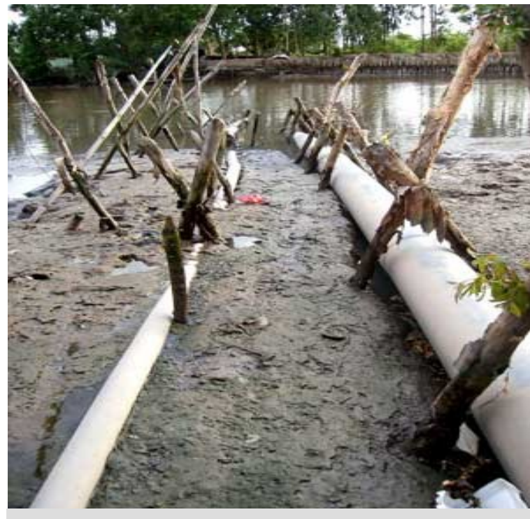
Hình 1: Cống xả nước thải và bùn đáy
