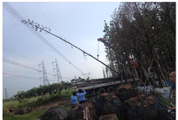
Hình 1.1: Ngọn cây dầu dính vào dây dẫn Pha C cách trạm 500kV Tân Định 2,5 km đường dây 500kV Tân Định (573, 574) - Di Linh (571, 572) (sự cố lúc 13g50, ngày 22 tháng 05 năm 2013-PTC4)
