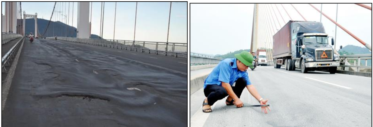
Hình 5. Hư hỏng của bản mặt cầu Thuận Phước Hình 6. Hư hỏng mặt đường trên cầu Bãi Cháy
