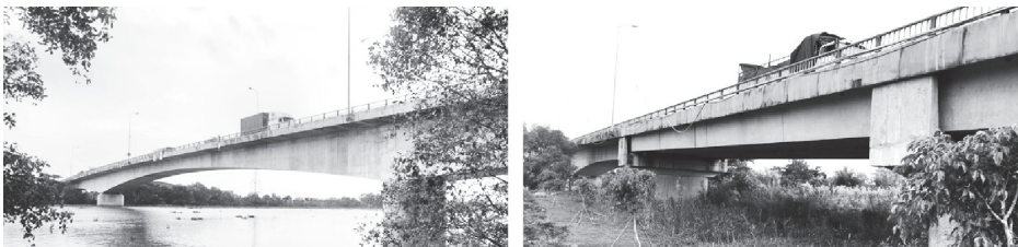
Hình 4. Cầu Tân An, nhịp liên tục (trái), và nhịp dầm Super - T (phải)
