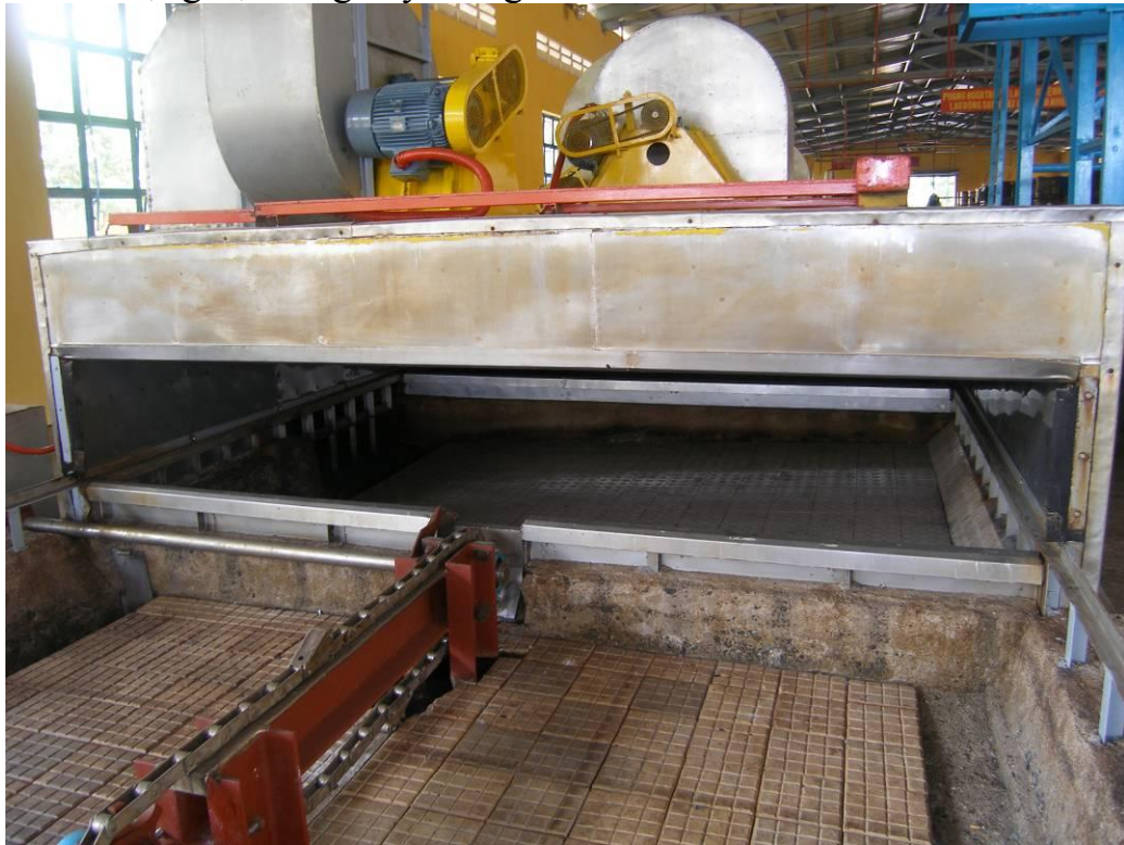
Hình 2.19. Hệ thống xích tải đưa thùng mù vào lò
