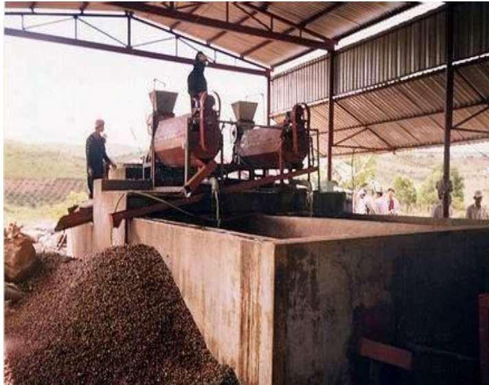
Hình 2.13: Thùng chứa là bể lên men bằng bê tông cốt thép
