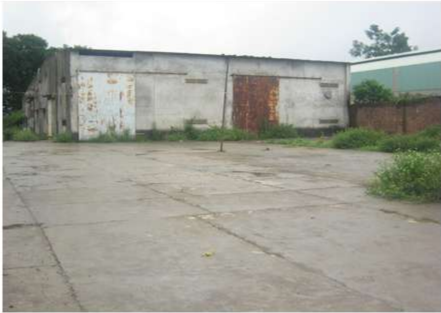
Hình 5.3.1: Nhà kho bảo quản Bời lời
