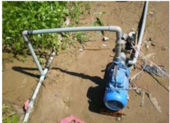
Hình 2.1.6 : Máy bơm nước trong vườn ươm
