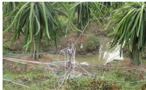
Hình 3.83. Các dây nguồn dẫn điện không an toàn
