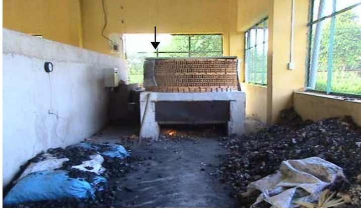
Hình 4.2.17. Lò than cung cấp nhiệt cho lò sấy lúa
