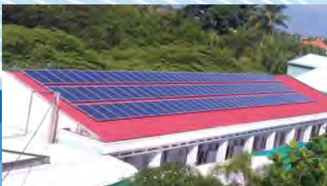
Thiết bị được lắp đặt tại Sở KH&CN Long An
