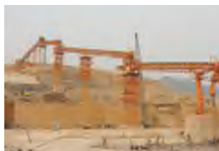
Hệ thống băng tải vận chuyển bê tông đầm lăn RCC
