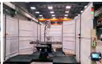
Hệ thống robot hàn công nghiệp
