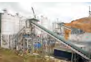
Trạm trộn bê tông lạnh
