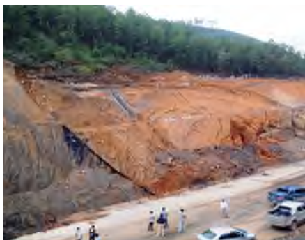
Trượt đất tại Km12 đường cao tốc Hạ Long - Vân Đồn (9/2017).
