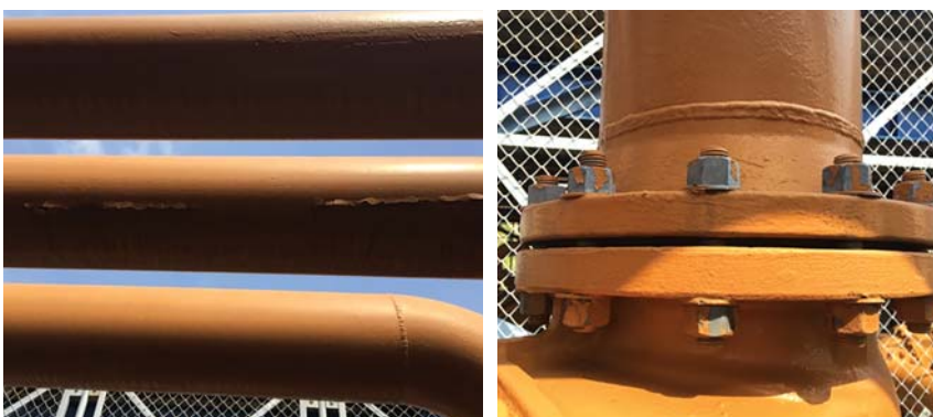
Hình 10. Đường ống dẫn dầu tại Nhà máy Điện Nhơn Trạch 2
