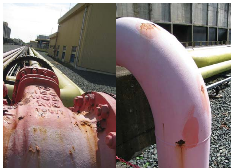
Hình 3. Bong tróc lớp phủ tại đường ống nước cứu hỏa Nhà máy Điện Cà Mau 1
