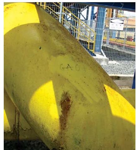
Hình 11. Đường ống dẫn khí
