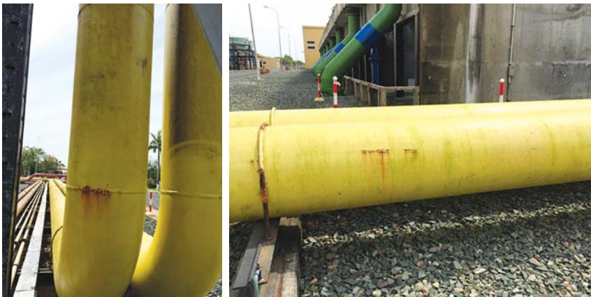
Hình 6. Đường ống dẫn khí Điện Cà Mau 1
