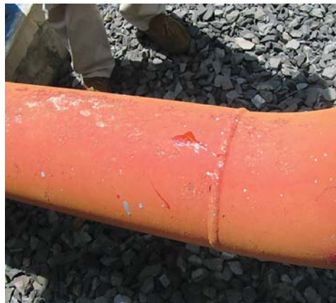
Hình 9. Đường ống nước cứu hỏa tại Nhà máy Điện Nhơn Trạch 2
