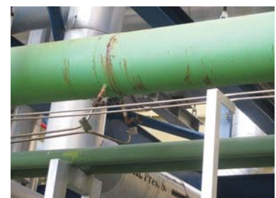
Hình 5. Đường ống nước làm mát khu vực chàm hydrazine Điện Cà Mau 1
