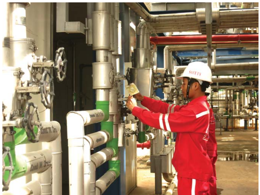
Công tác bảo dưỡng, sửa chữa tại các nhà máy điện đảm bảo chất lượng, tiến độ. Ảnh: PV Power
