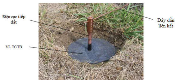
Hình 1. Một phần hệ thống tiếp đất.
