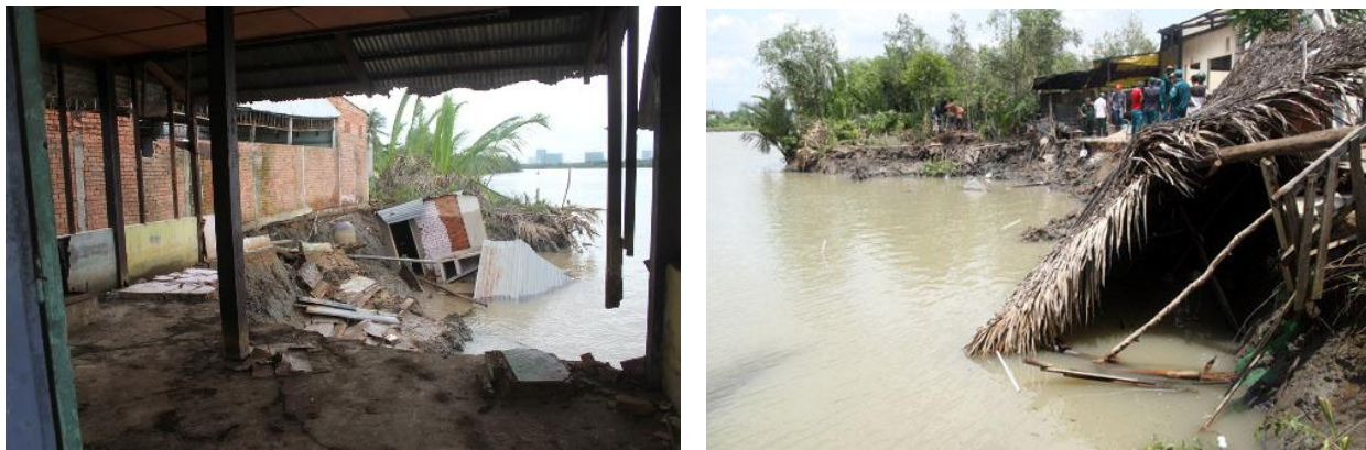
Hình 2. Sạt lở tại khu vực sông MC, huyện Nhà Bè (Phụ nữ Online và VnExpress)
