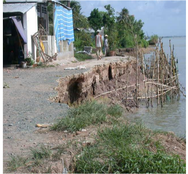
Hình ảnh sạt lở tại khu vực Sa Đéc – Đồng Tháp
