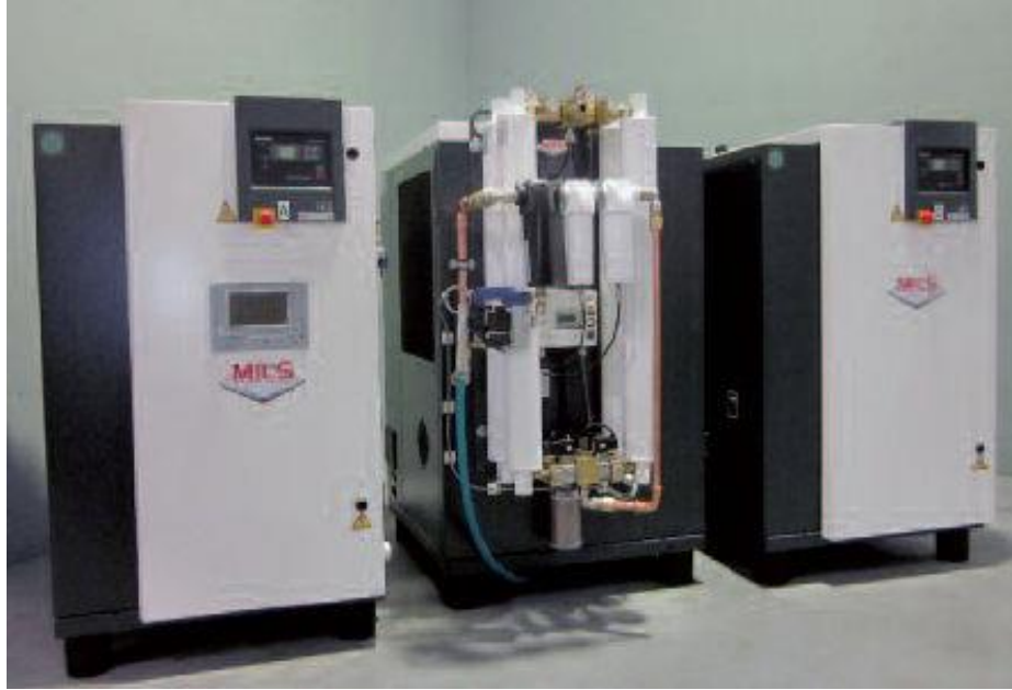
Hình 2.14 Hệ thống nén khí y tế MA4 và SA7
