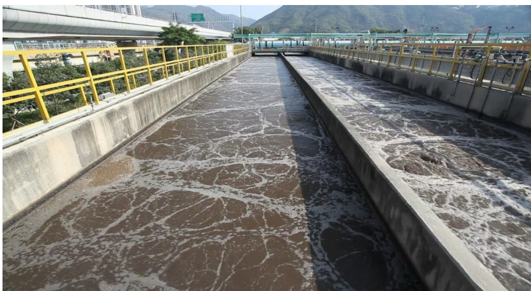
Hình 1. 6 Bể điều hòa
