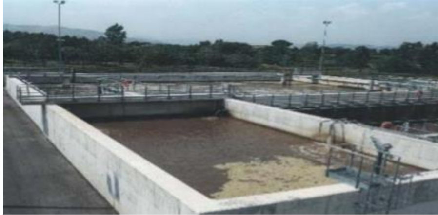
Hình 2. 3 Bể điều hòa
