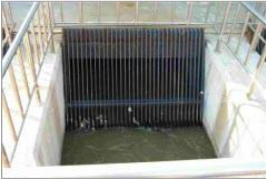
Hình 1.4. Song chắn rác thô vệ sinh thủ công
