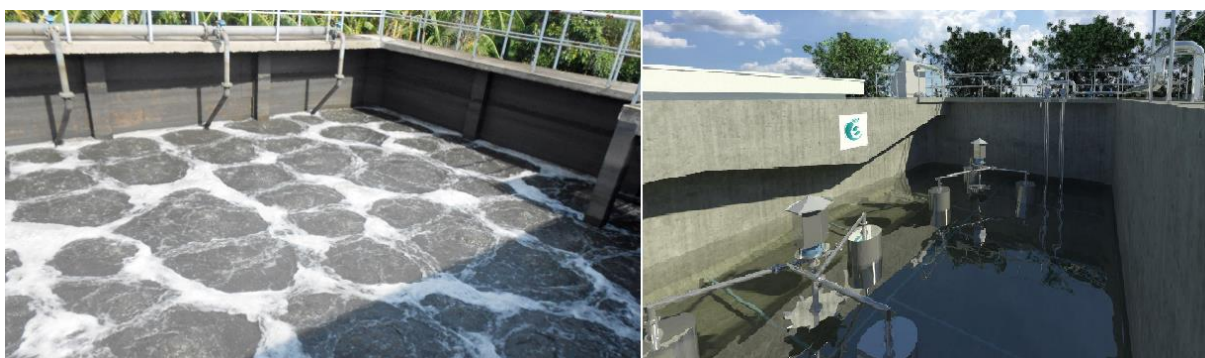
Hình 1.7. Bể điều hòa sục khí và bể điều hòa khuấy bề mặt (cokhimoitruong.com.vn)
