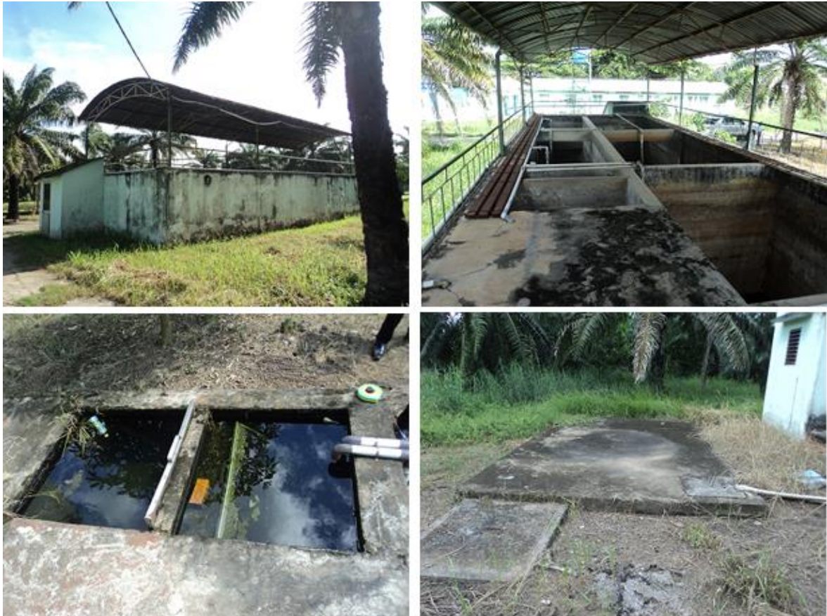
Hình 1.5. Trạm xử lý nước thải sinh hoạt hiện hữu
