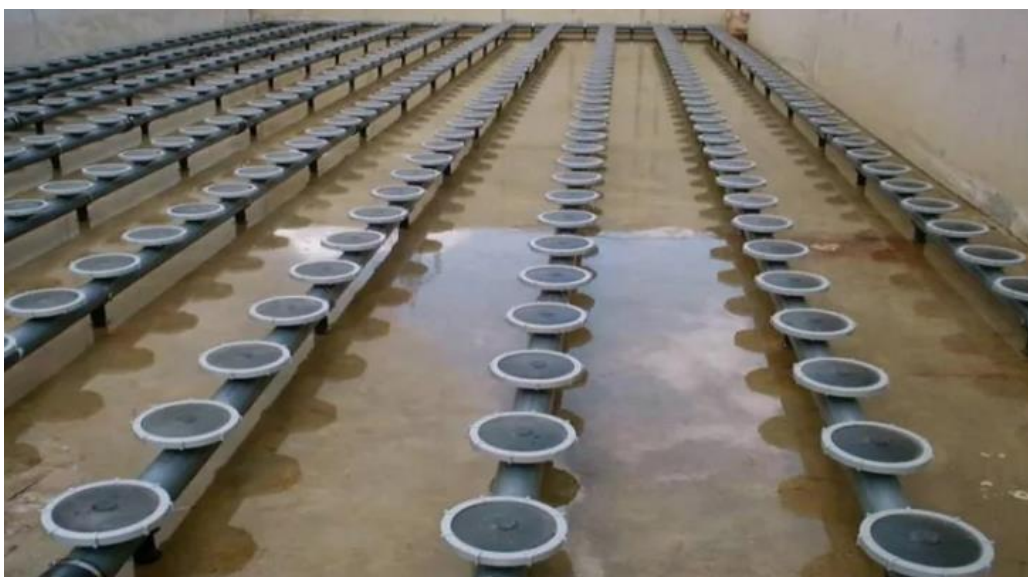
Hình 2.7: Đĩa thổi khí trong bể Aerotank
