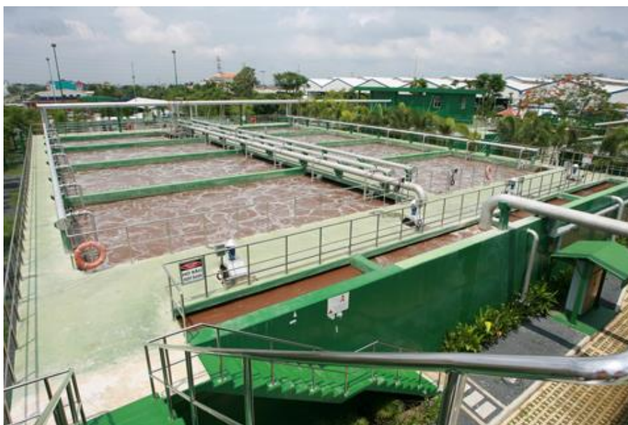
Hình 2.5: Hệ thống xử lý nước thải thực tế
