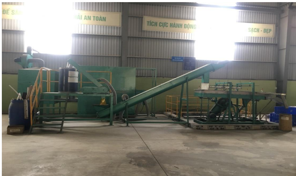
Hình 3.4. Hệ thống xử lý bóng đèn huỳnh quang
