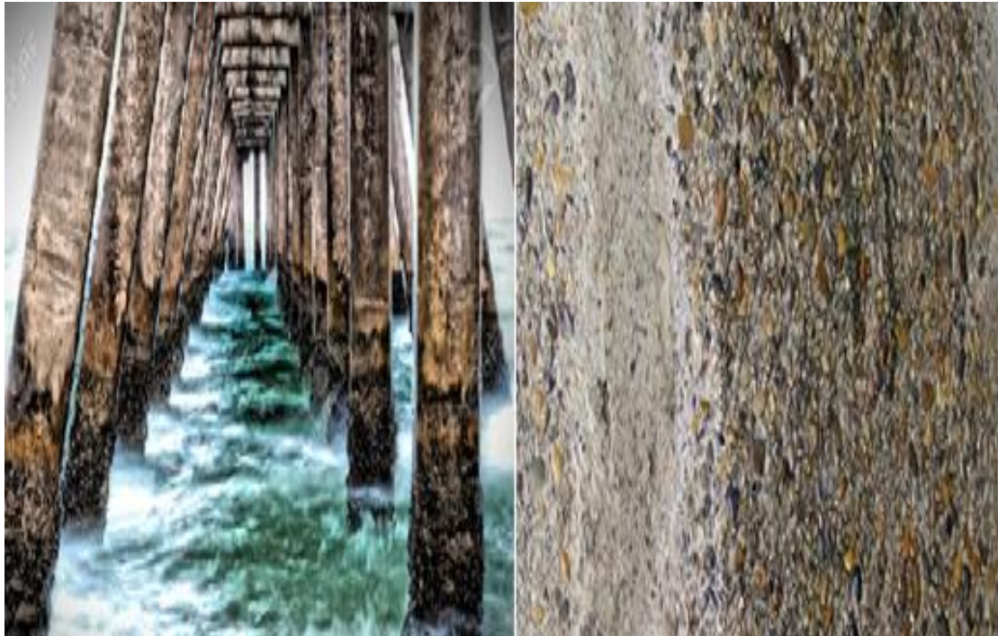
Hình 1.4. Tác động của sóng biển gây mài mòn đối với kết cấu bê tông
