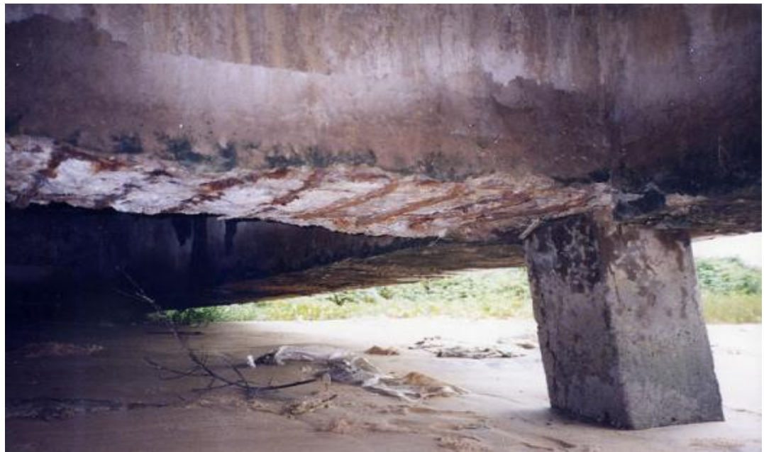
Hình 1.3 Ăn mòn bê tông cốt thép [4]
